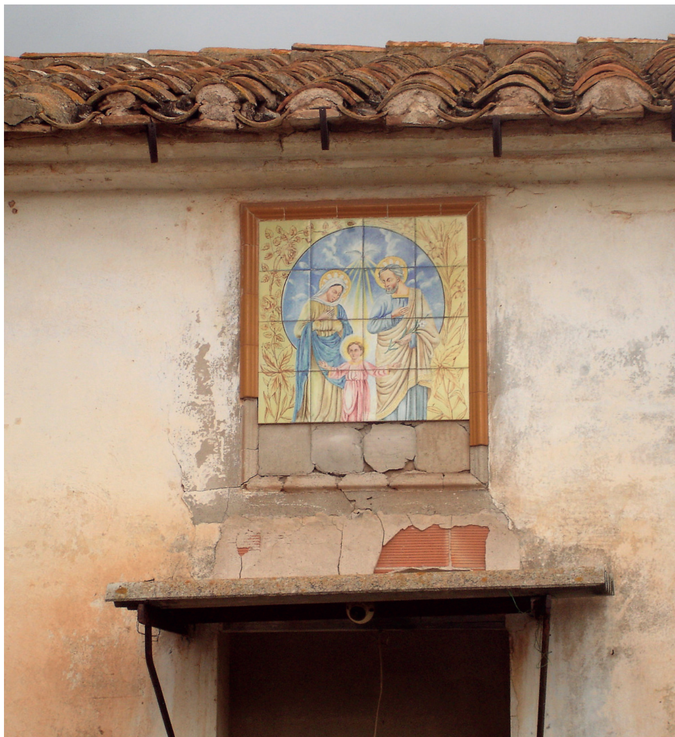
Estat del plafó el 2018. – Estado del plafón en 2018. Fot. P. Garcia.
